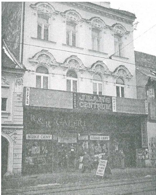
Úplná deštrukcia parteru historickej budovy s prekrytím kordónovej rímsy. Obchodná ul., PZ Bratislava
